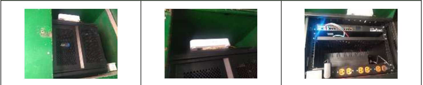
Instalación Router y Switch para sistema de cámaras de videovigilancia
