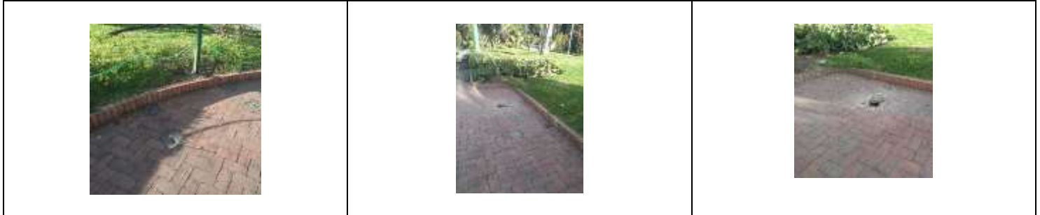
Reporte y reparación de huecos por sillas hurtadas
